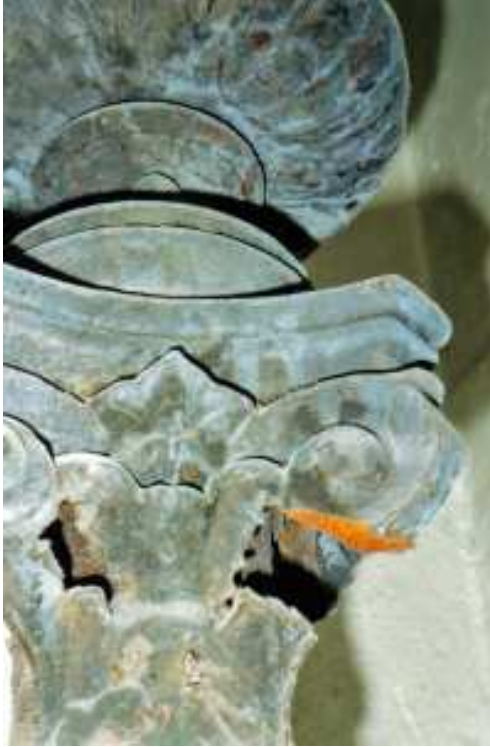
Fehlendes Teil oberhalb der Lisene
