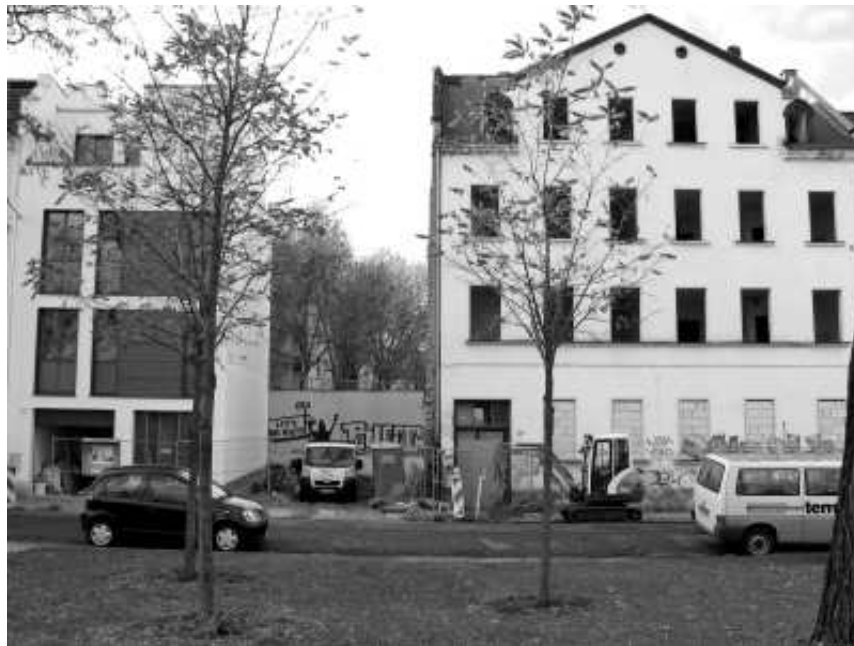
Rabet 32a ist fertig, Rabet 30 wartet auf den unumgänglichen Abriss.
